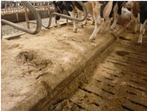
Figur 12 Der er huller under bøjlerne mange steder i 8 år gamle kanalrader.
